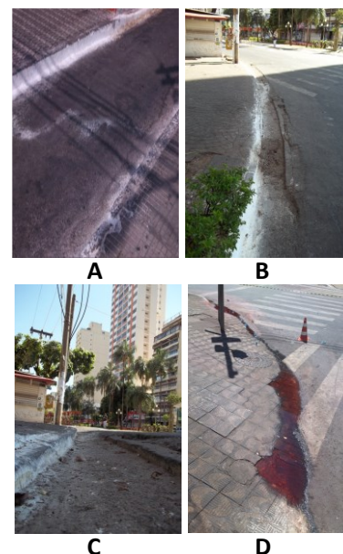
Figura 10. (a) Ausência de rampa de acesso - Quadra 11; (b) e (c) Ausência de rampa de acesso - Quadra 9 esquina com Avenida Anhanguera; (d) Rampa de acesso levando a acúmulo de água - Quadra 5 esquina com Rua 2.
