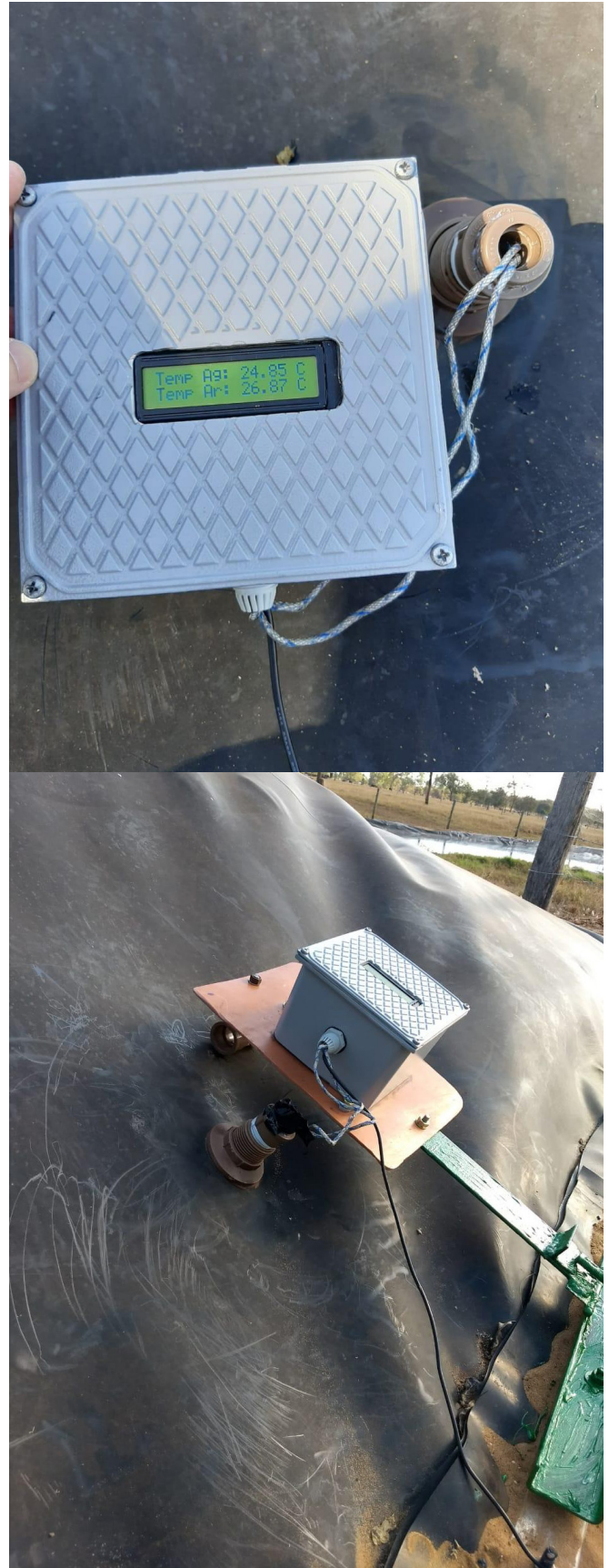
Figura 3. Datalogger com sensores de temperatura instalado em biodigestor. Fonte: autores.
