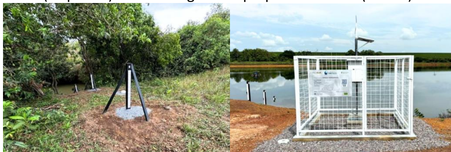
Figura 3. Estação de monitoramento de oferta de água no rio Samambaia (esquerda) e em barragem em propriedade rural (direita).
